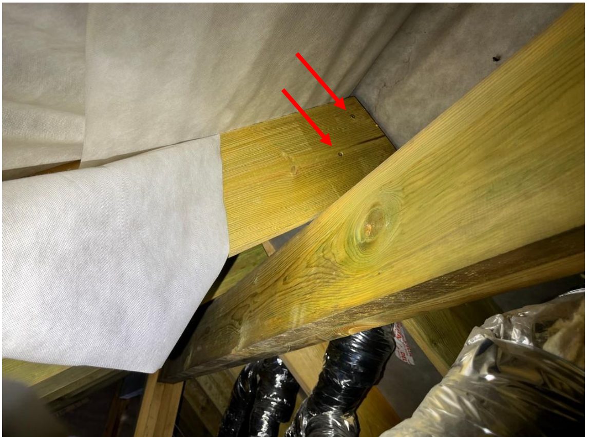
Фото 18. Узел стыка стропил в коньке выполнен на 2 самореза
