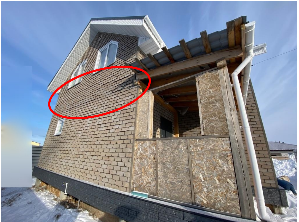
Фото 22. Отслоение фасадных плиток «Хауберг» в уровне перекрытия
