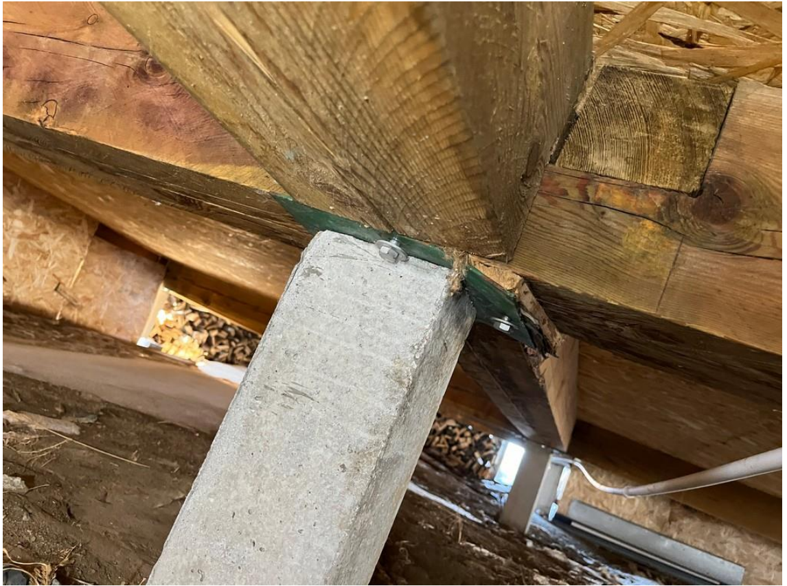
Фото 21. Нарушена целостность гидроизоляционной прокладки между оголовком сваи и обвязочным брусом
