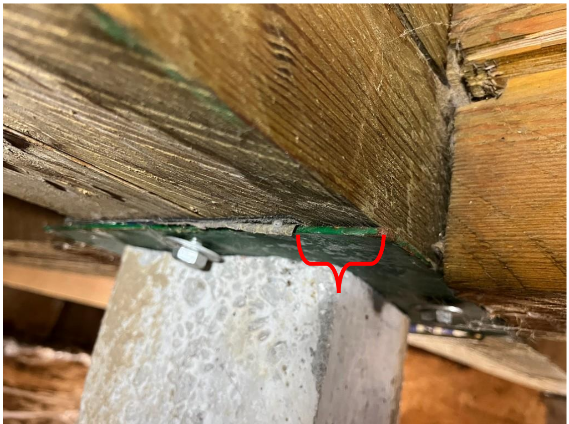
Фото 20. Нарушена целостность гидроизоляционной прокладки между оголовком сваи и обвязочным брусом
