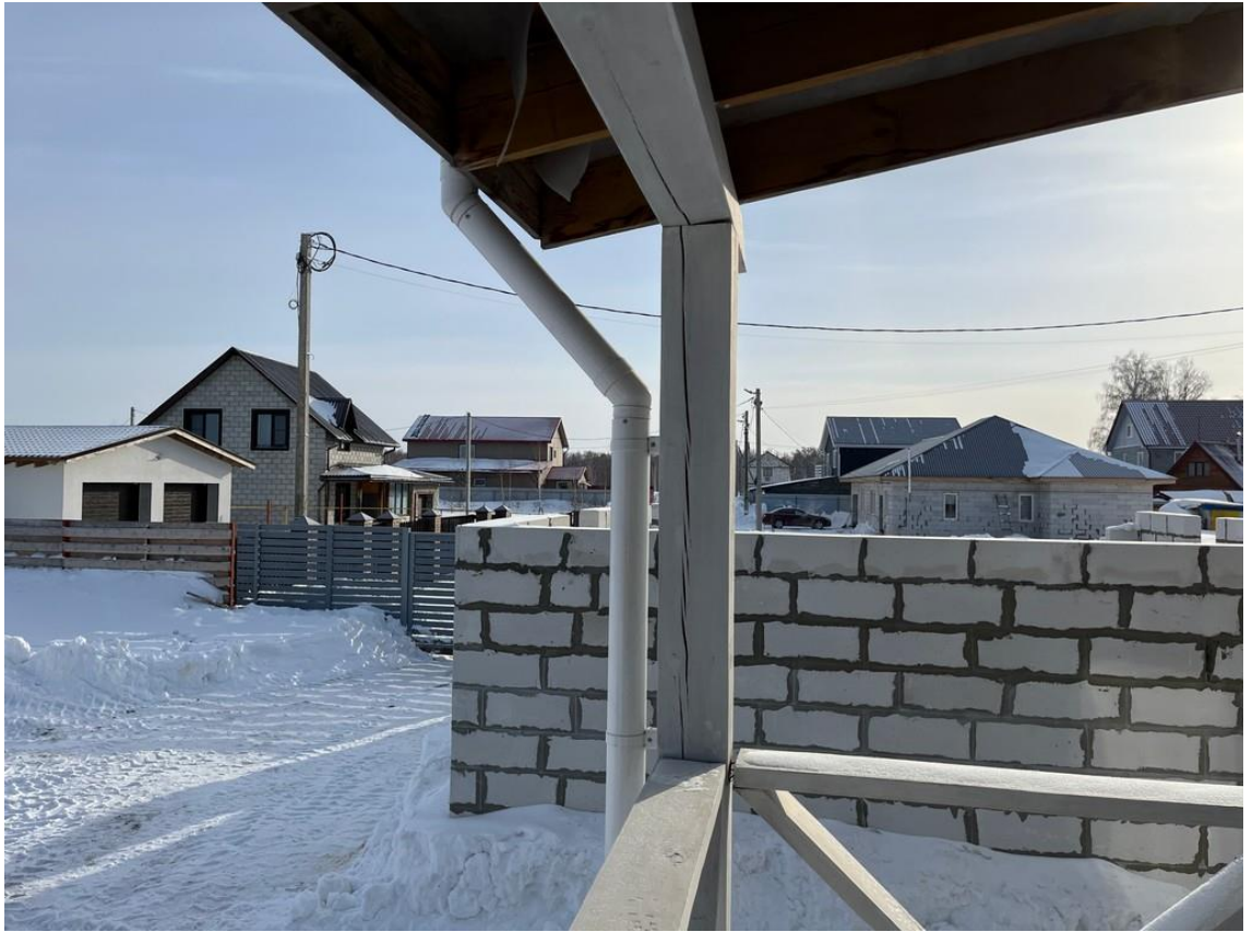
Фото 17. Трещины усушки деревянных стоек террасы
