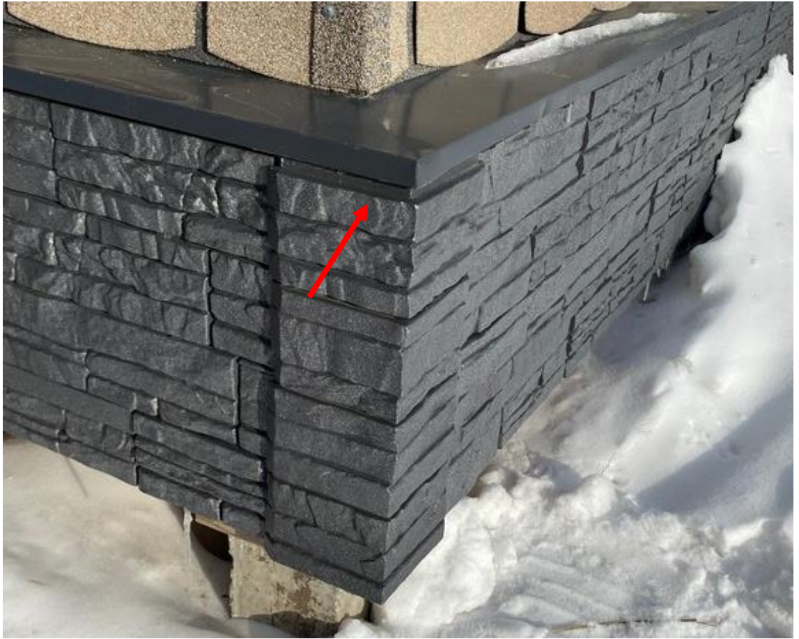
Фото 7. Зазор между отделкой цоколя и торцевыми пластинами
